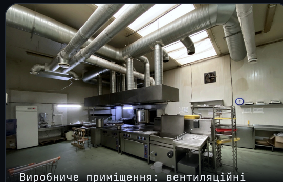
Виробниче приміщення: вентиляційні короби
