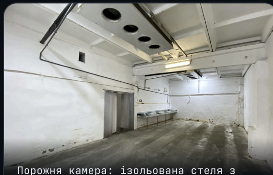
Порожня камера: ізольована стеля з вентиляцією
